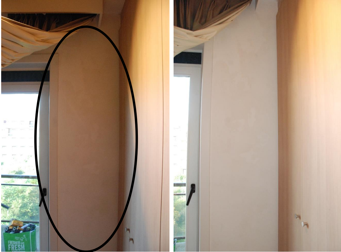
Sporen van vochtinfiltratie aan de binnenkant van de muur.
